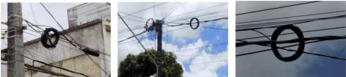
Figura 02. Instalações irregulares de reversas técnicas tipo cruzeta
